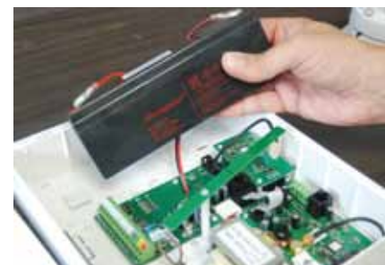
Ein 12 Volt-Akku sichert die Alarmanlage gegen plötzlichen Stromausfall ab.
