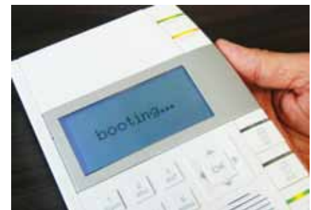
Auf dem Display wird der aktuelle Ist-Zustand des Systems angezeigt.
