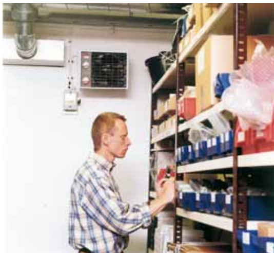
Ruimtes die slechts af en toe worden gebruikt, kunnen snel op elk gewenst moment met een luchtverhitter worden verwarmd.
